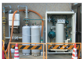
新潟中越沖地震 老人福祉施設
